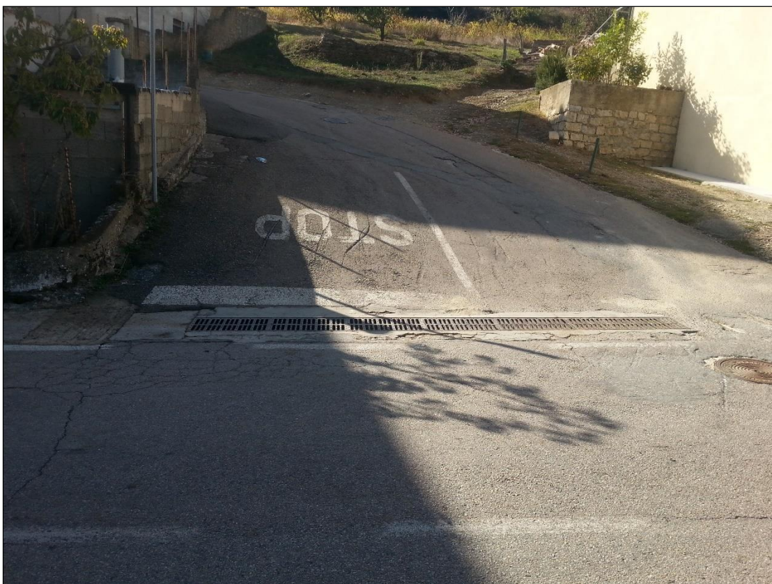
Figura 8 Imbocco sistema Riu Nestasi
