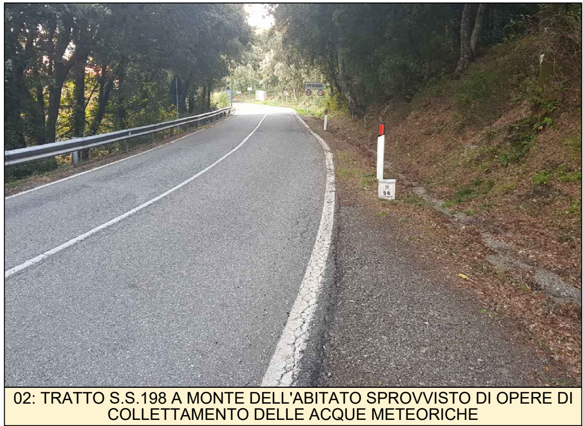
02: TRATTO S.S.198 A MONTE DELL'ABITATO SPROVVISTO DI OPERE DI COLLETTAMENTO DELLE ACQUE METEORICHE
