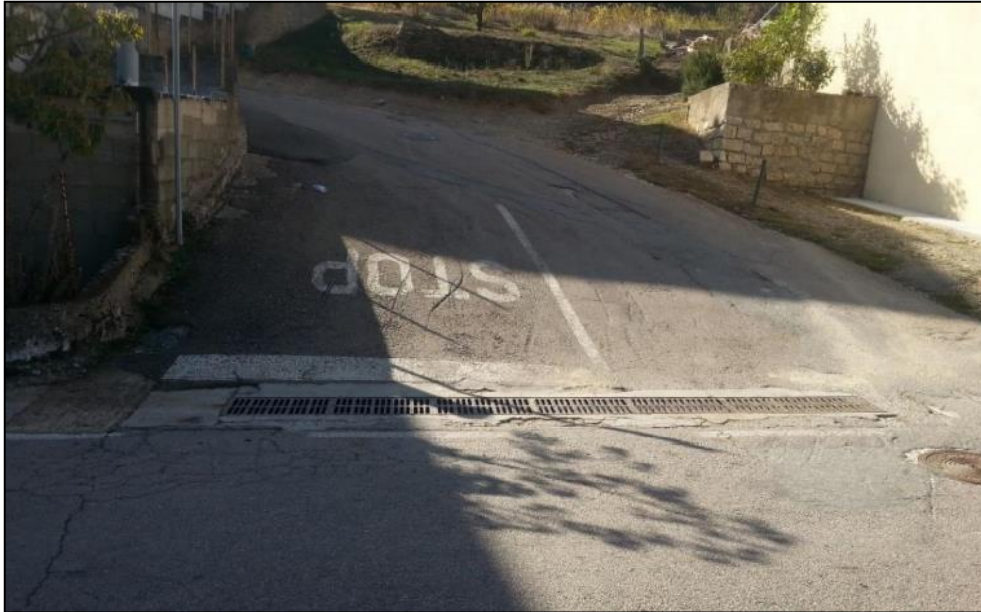
Figura 17 – Imbocco sistema Riu Nestasi
